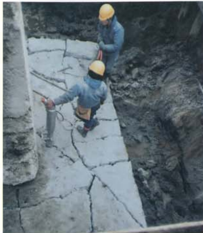
送電鉄塔基礎破壊(C11SL2連)
